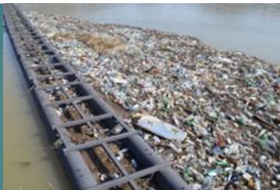
Slika 45 Pregrada za zaustavljanje otpada
